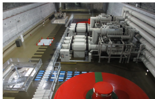
発電機および付帯設備
